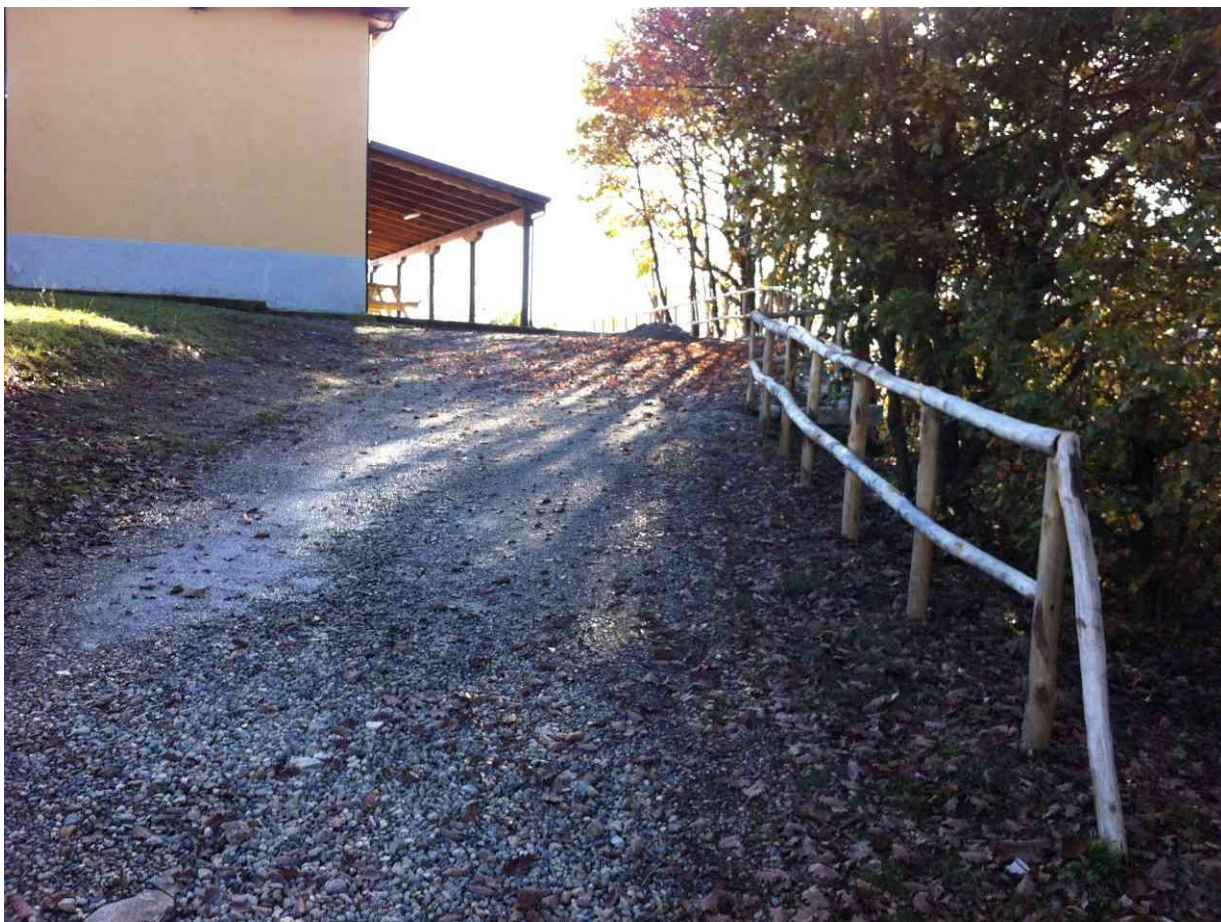
Vista Santuario di S. Maria Ausiliatrice – staccionata a protezione parti esposte - Dopo i lavori
